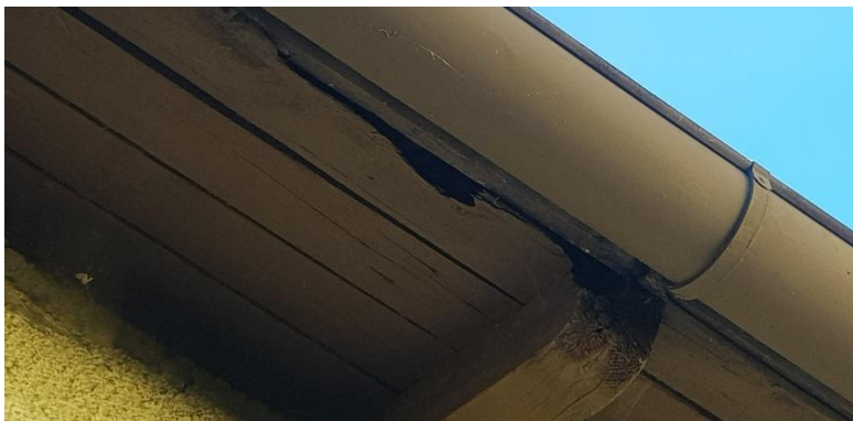
Abb. 6: Schadstelle an der Scheune mit darunter liegenden Kotteilen (Foto: Birgit Schwark 10.11.22)
